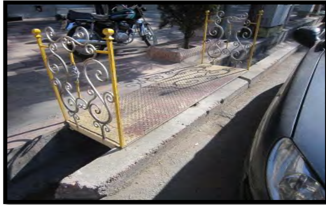
شکل (۹): اختلاف ارتفاع پل با خیابان، مقابل بانک پارسارگاد، آبان ۱۳۹۱
