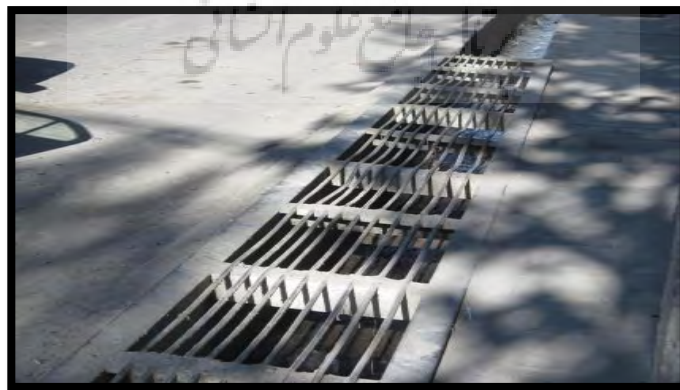
شکل (۱۰): کف سازی نامناسب پل، مقابل موسسه عالی میر داماد، آبان ۱۳۹۱
