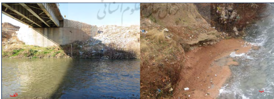
شکل (۵): الف) برش بستر رودخانه در پایه پل، ب) برش و فرسایش حاشیه رودخانه در بخش دوم رودخانه خرم رود
