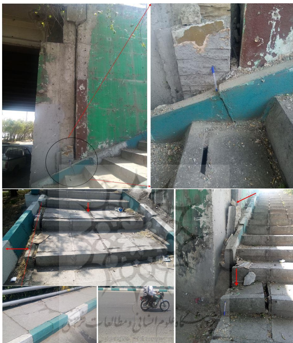
شکل ۷- تصاویر مربوط به تأثیرات فرونشست بر پل شماره ۳ (تقاطع بزرگراه کاظمی و بلوار شکوفه)
