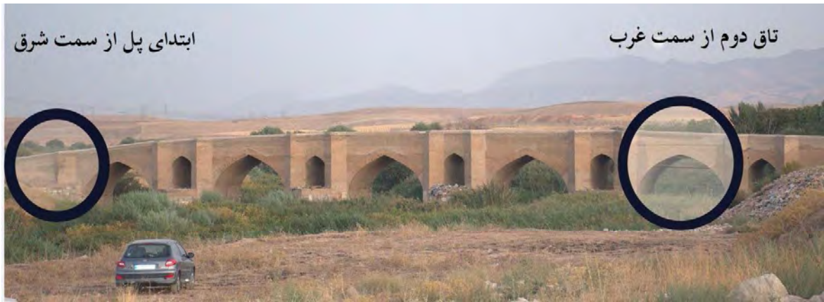
تصویر ۷: قسمت‌های تخریب‌شده در پل در جنگ جهانی اول - چشمه تاق دوم از سمت غرب و ابتدای پل از سمت شرق (نگارندگان، ۱۴۰۳). Fig. 7: Parts of the bridge destroyed in World War I - The second arch spring from the west and the beginning of the bridge from the east (Authors, 2024).
