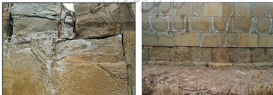
شکل ۱. ب) تبلور نمک‌ها بر دیوار سنگی قلعه در محوطه‌ی بیرونی گنبد سلطانیه و از دست رفتن بخش‌هایی از سنگ به دلیل فشار تبلور.
