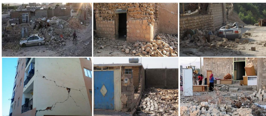
شکل ۱: تصاویری از خسارت‌های ناشی از زلزله رخ داده در مورخه ۱۳۹۳/۰۵/۲۷ آبدانان
